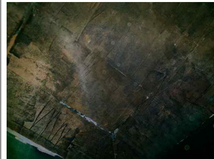
<배수지 2지 상부슬래브 균열>
