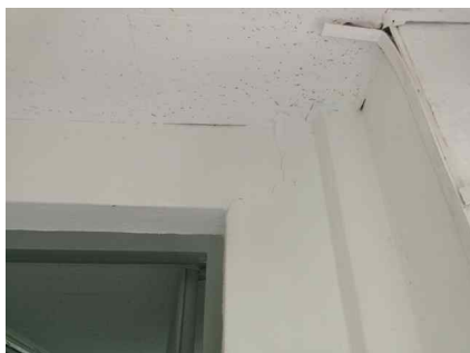
<관리실 내부 벽체 균열>
