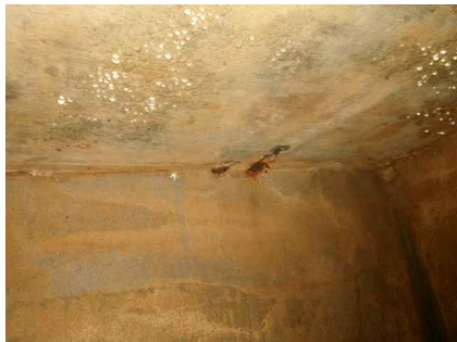
<유입밸브실(2지) 벽체 파손>
