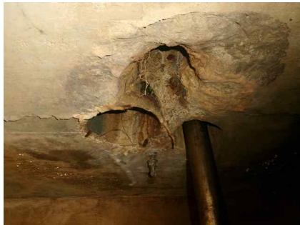
<유입밸브실(2지) 상부슬래브 백태>
