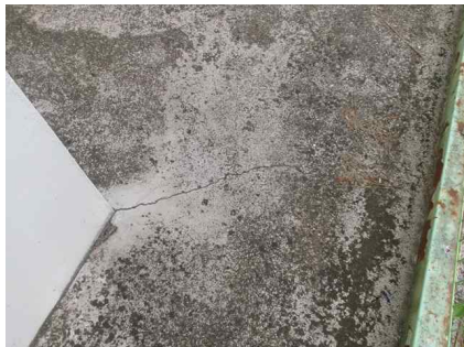
<검수실 외부 바닥 균열>
