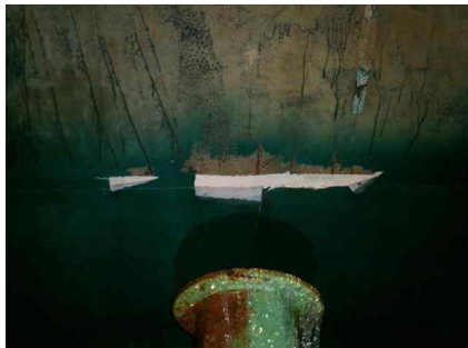
<배수지 1지 상부슬래브 도장손상>
