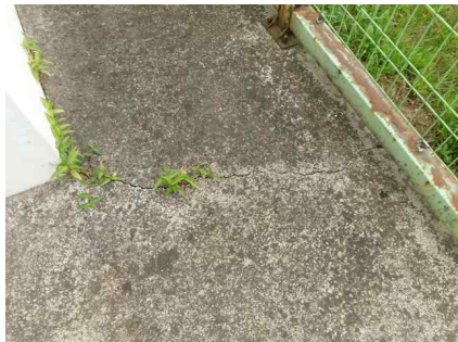
<검수실 외부 바닥 균열>
