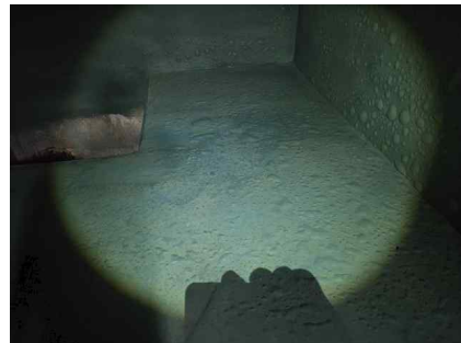
<배수지 2지 바닥슬래브 도장기포>
